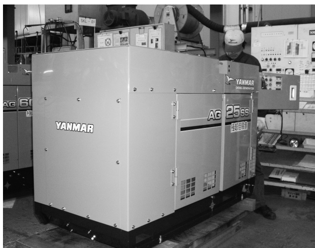
ヤンマー建機の可搬形発電設備
