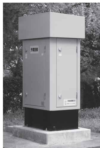
5kVA 空冷ディーゼル非常用発電機
