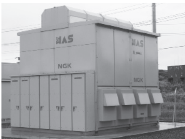
日本ガイシの NAS 電池 (1,500kW)
