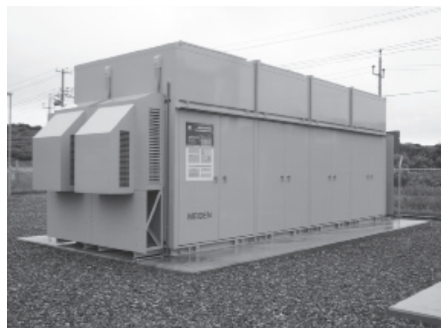
明電舎が開発した NAS 電池用パワーコンディショナー (1,000kW)
