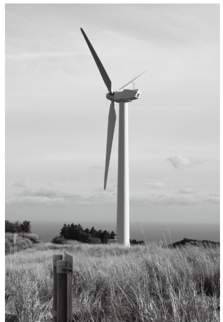
三菱重工製600kWの東伊豆町風力発電所(静岡県)
