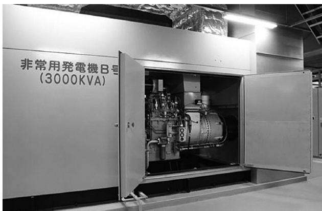
屋内用キュービクル式の非常用ガスタービン発電設備 (東京・汐留、シティーセンター)
