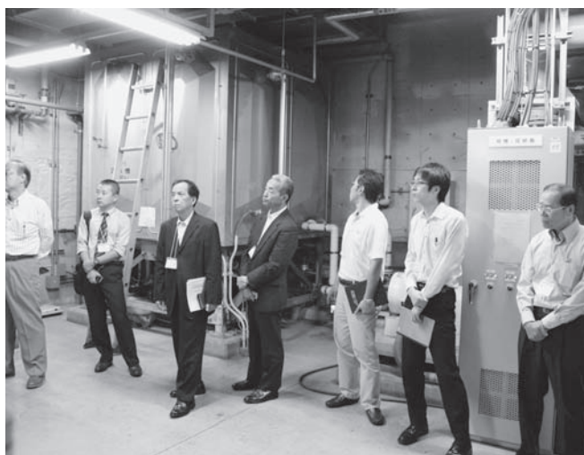
リハビリセンターの機械室
