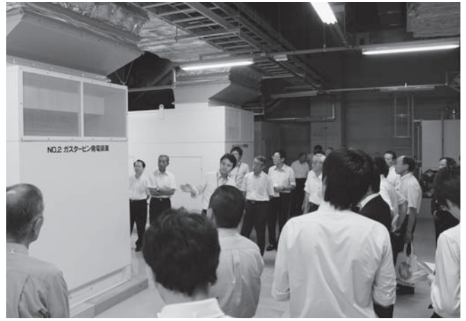
1,000kW × 2台のガスタービン発電設備
