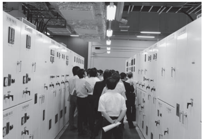
電源設備の監視盤
