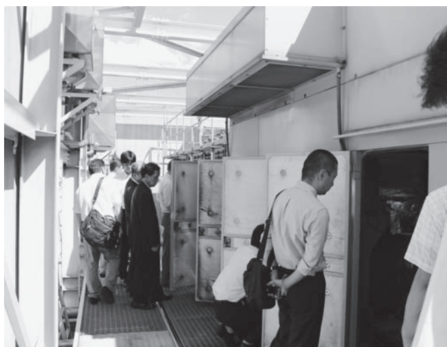
リハビリセンター屋上の350kWガスエンジンコージェネ
