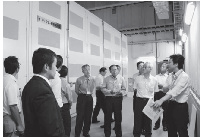
1,000kWのNAS電池
