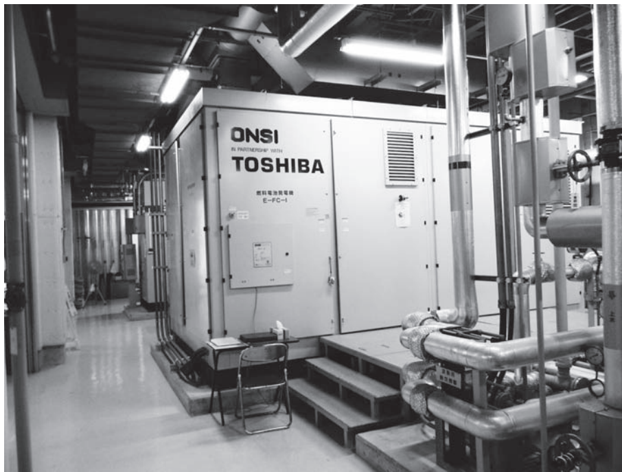
りん酸形燃料電池発電設備
