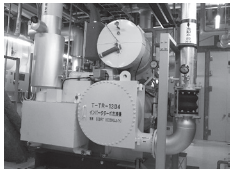
インバーターターボ冷凍機
