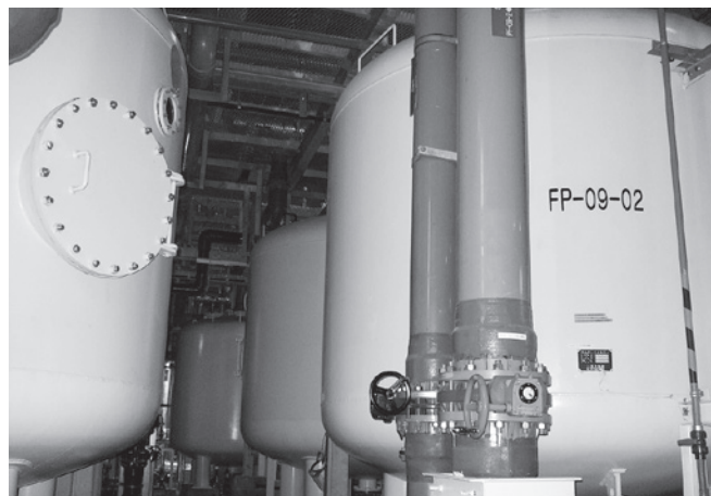
サンゴ砂反応塔(ろ過装置)
