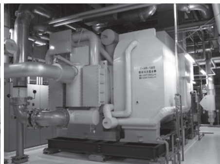
ガス焼き吸収式冷温水機
