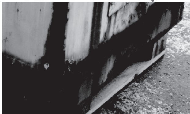
図3 側板部が発錆及び腐食し破孔
