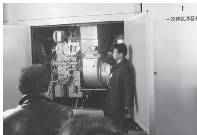
写真2 ガスタービン発電設備の説明風景
