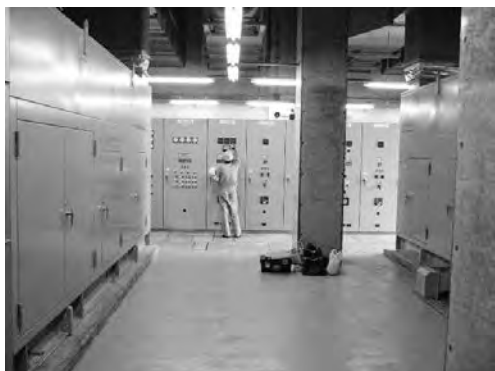
某官庁施設の発電設備室内
