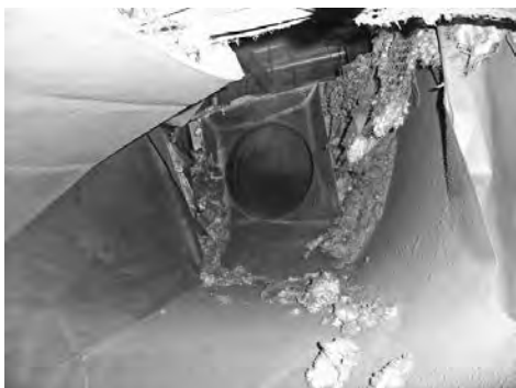
爆発した煙道（排気ダクト）
