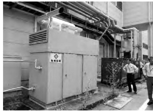
写真-3 防災用自家発電設備
