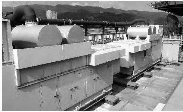
写真-7 防災新館に設置された自家発電設備
