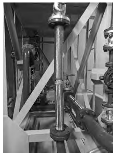
架台により高い位置に設置されたオイルポンプ
