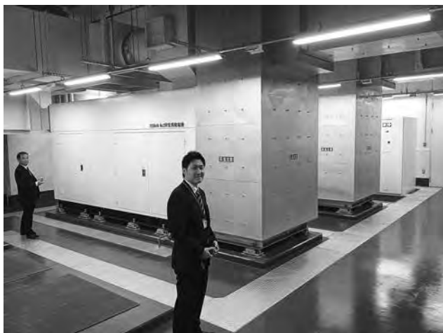
ガスタービン駆動方式の非常用発電設備（1,250kVA）
