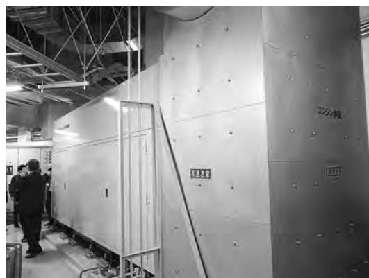
ガスタービン駆動方式の非常用発電設備（2,000kVA）
