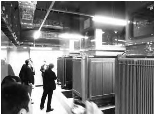
受電Tr (変圧器)
