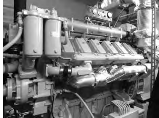
ディーゼル機関駆動の非常用発電設備
