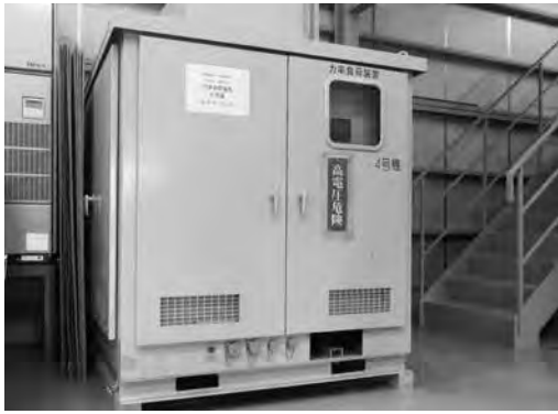
力率負荷試験装置 4号機220kVA・220V（60Hz）
