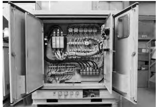
（写真上の右）力率負荷装置4号機（160kW）の内部配線 「常用LPガスエンジン発電設備（LPG-G5000S）」 の展示を行い、全国各地から集まった来場者たちの 注目を集めていました。
