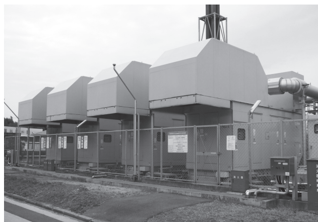
豊橋製作所内のディーゼル発電設備
