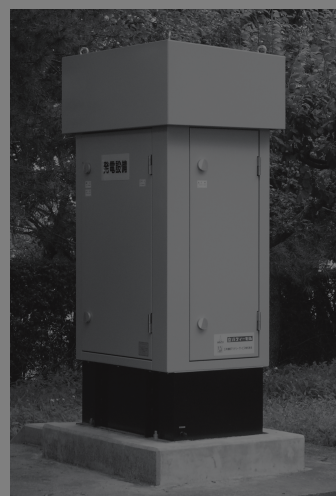
5kVA 空冷ディーゼル非常用発電機
