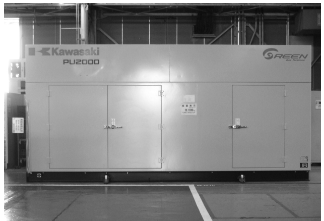
PU2000 GREEN Gas Turbine（非常用 2,000kVA）
