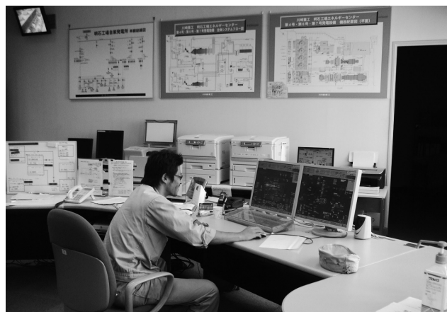
自家発電所の操作室
