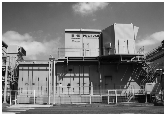
明石工場の自家発電所
