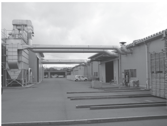
左が木質バイオマス乾燥設備。右の工場から同設備へとパイプを通し、木くずが送られる。
