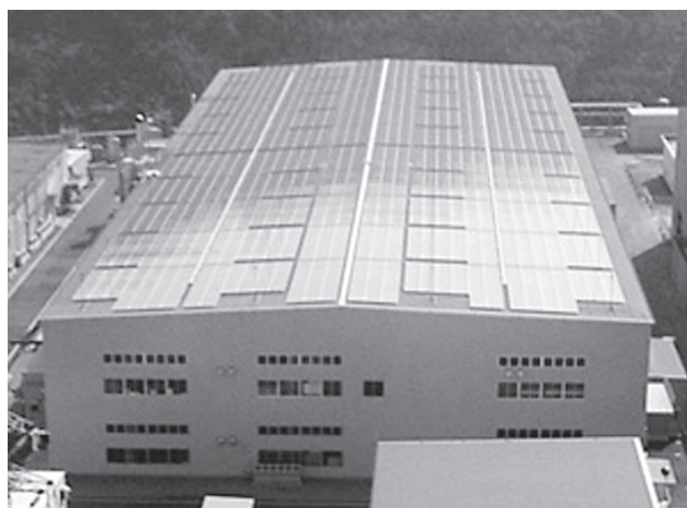
図2 工場の屋根に設置された太陽電池
