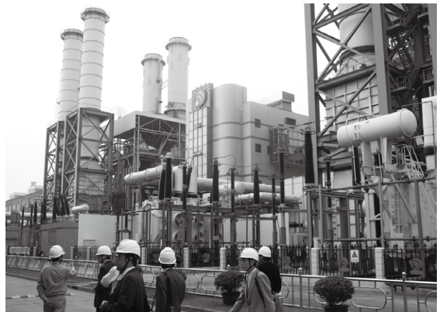
上海開電ガスタービン発電所
