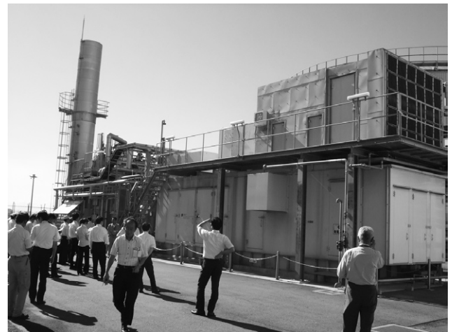
エネルギーセンターのガスタービンコージェネ
