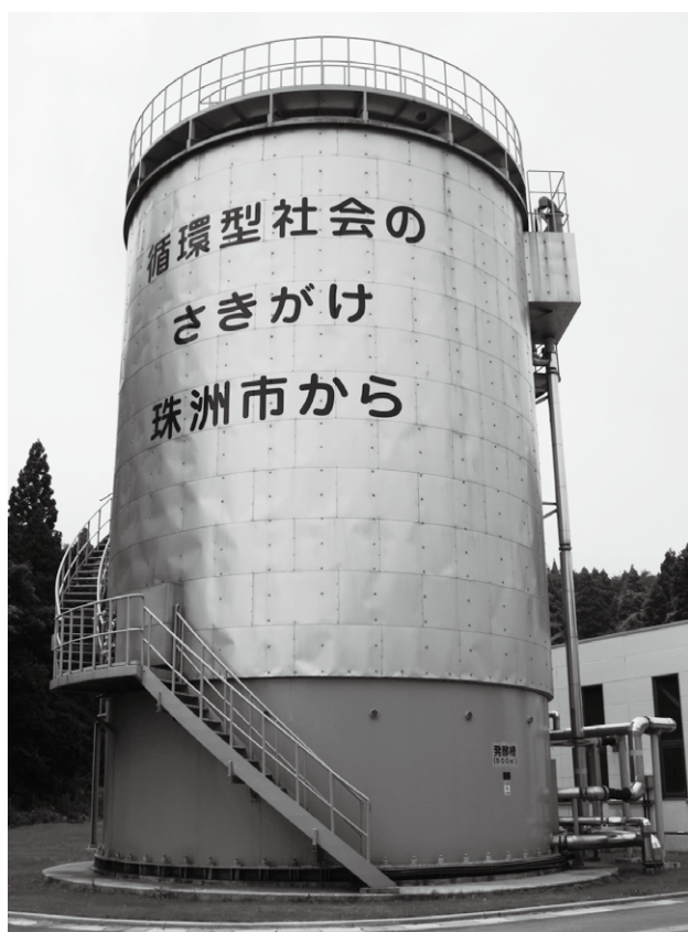
写真9 メタン発酵槽
