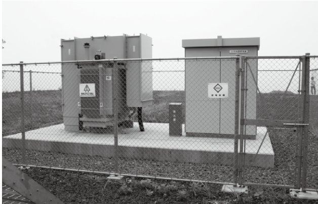
写真2 トランスを収納した小屋
