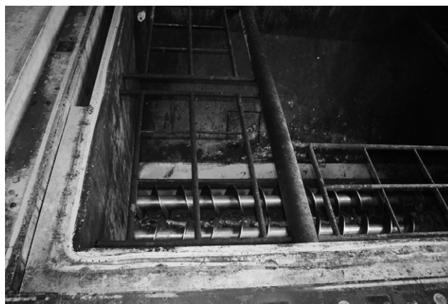
写真6 生ごみの受入れ口
