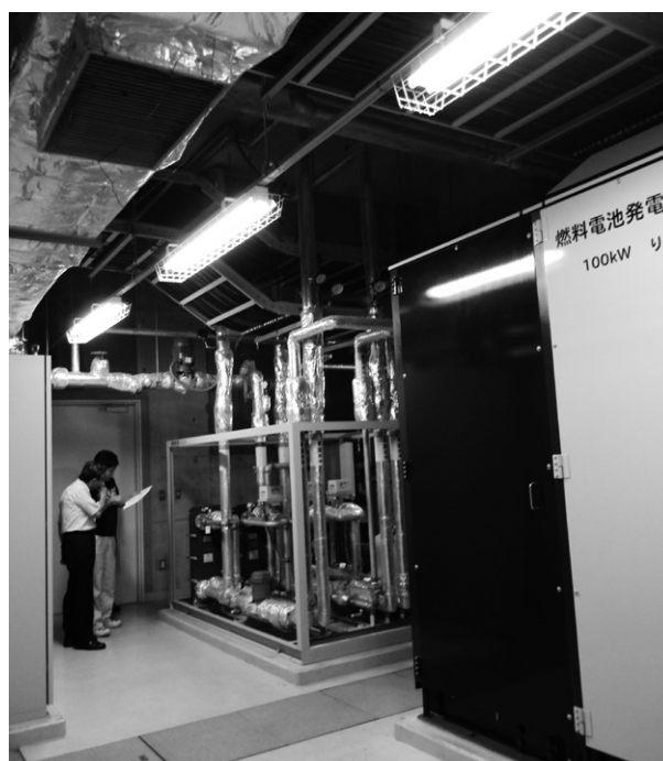
発電機室内の燃料電池と排熱処理ユニット (奥)
