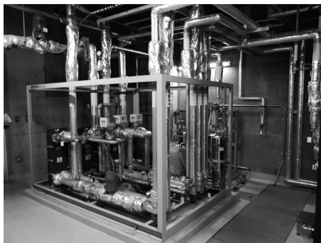
排熱処理ユニット
