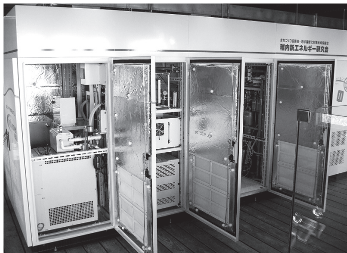
7kWの燃料電池システムの内部
