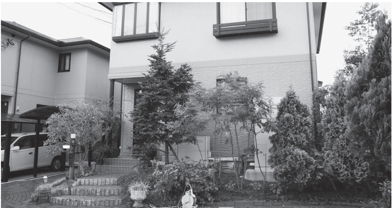
発電ユニットと貯湯ユニットからなるエネファームが戸建て住宅の玄関右横に設置されている
