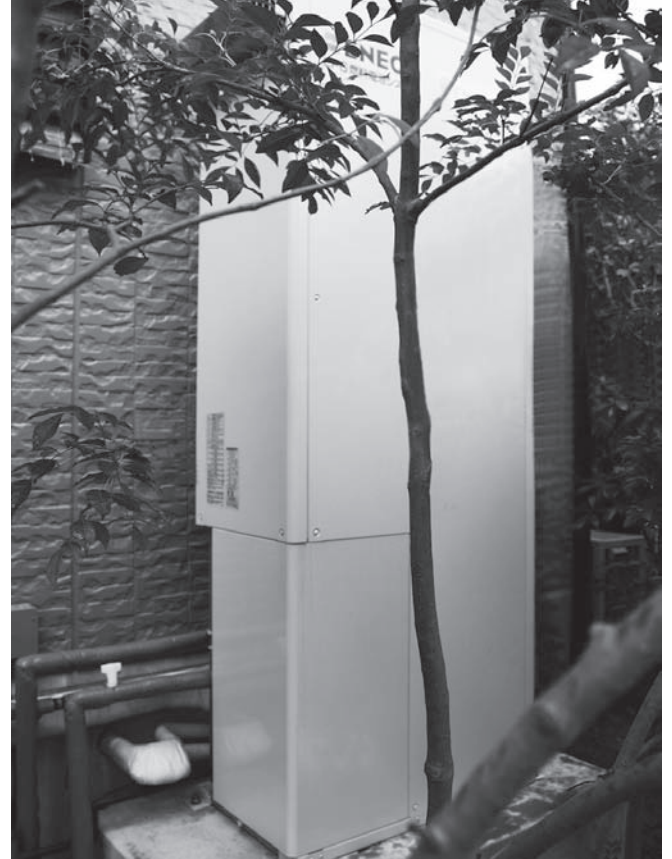
南風台・美咲が丘の戸建て住宅に設置されたエネファームの貯湯ユニット。高さは176cm
