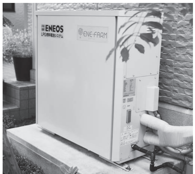
南風台・美咲が丘の戸建て住宅に設置されたエネファームの発電ユニット。エアコンの室外機ほどの大きさだ
