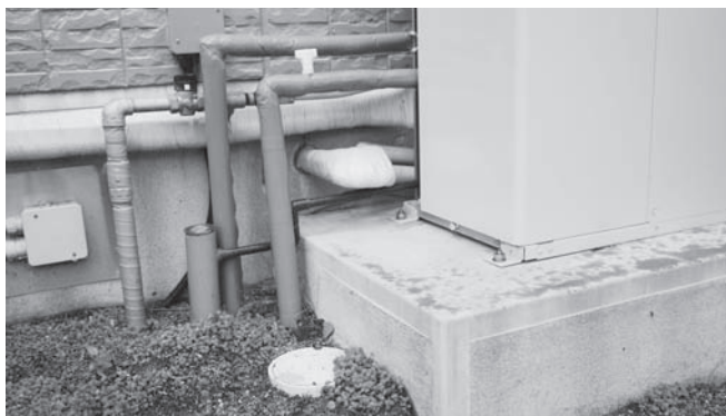
貯湯ユニットの基礎と配管部分
