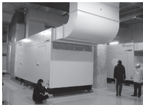
3,000kVAの防災用ガスタービン
