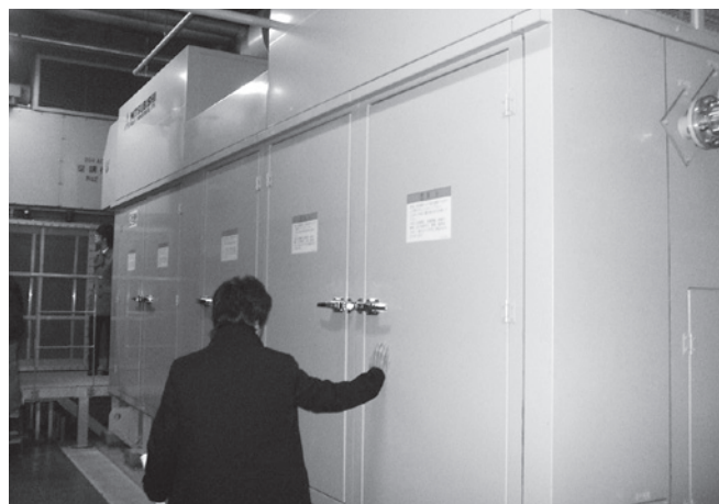
出力815kWのガスエンジンコージェネレーション
