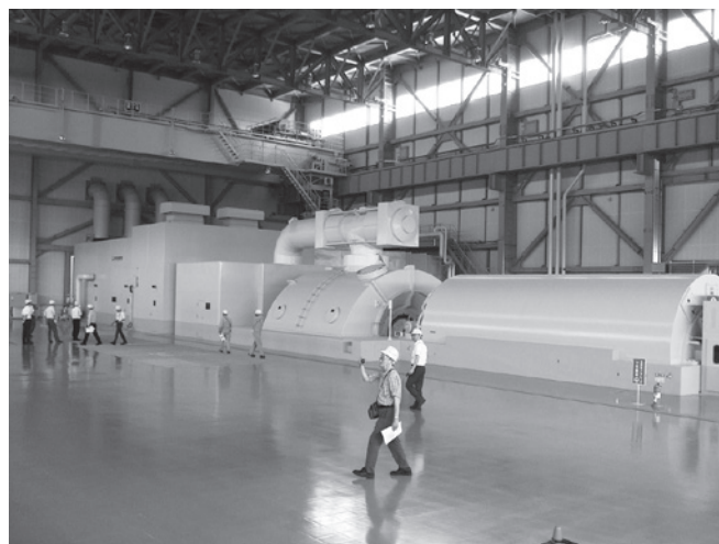
出力44万6,000kWのガスタービン（三菱重工業製）
