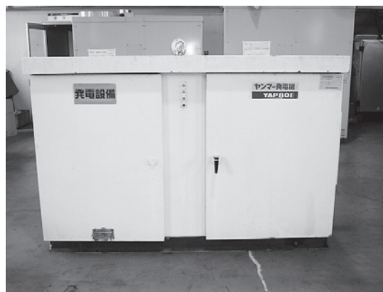
写真1 キュービクル正面
