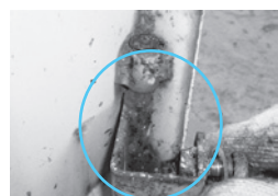
写真5 キュービクル扉ヒンジ部腐食
