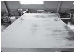
写真2 キュービクル天板部発錆
