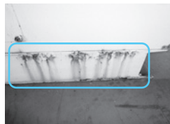
写真3 キュービクル側面の共通台板部腐食
