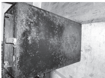
写真9 燃料タンク底面 腐食及び発錆
