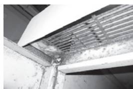
写真6 キュービクル換気(吸気)ガラリ腐食
