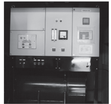
850kVA発電設備の内部
