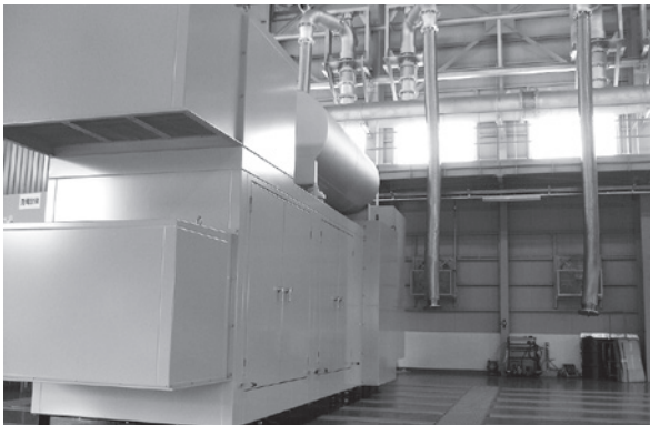
奥に検査装置の排ガスホースがみえる
