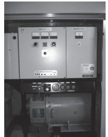
発電機盤と蓄電池充電装置
