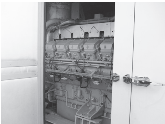
ガスエンジンコージェネの内部
