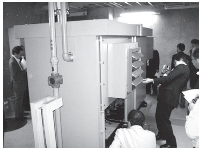
防災用ディーゼル発電設備（札幌アスペンホテル）
