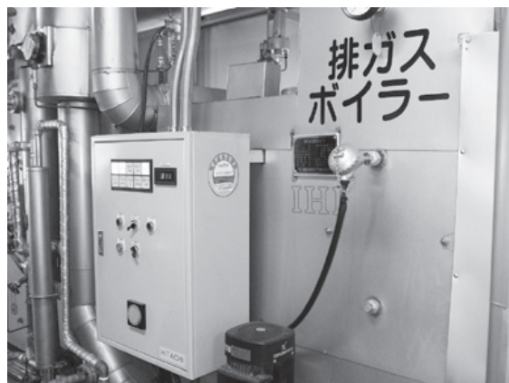
排ガスボイラーシステム
