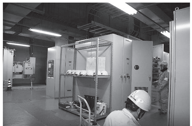
特高受変電設備
