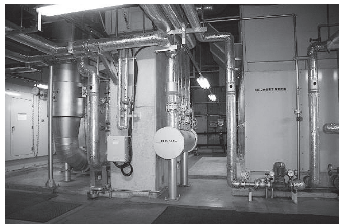
コージェネレーションシステム
