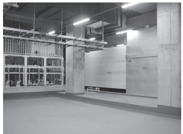
写真3 非常用ガスタービン発電設備全景
