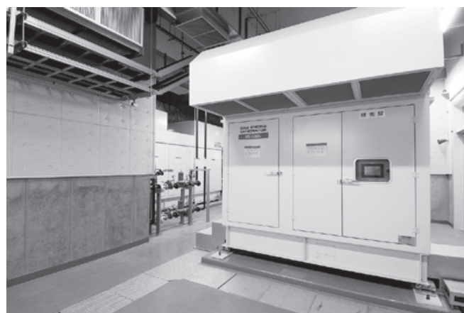
写真1 ガスエンジンCGSパッケージ
