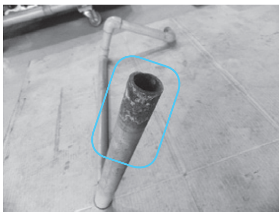
写真25：エンジン冷却水パイプの発錆
