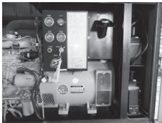
写真3：キュービクル発電機側
