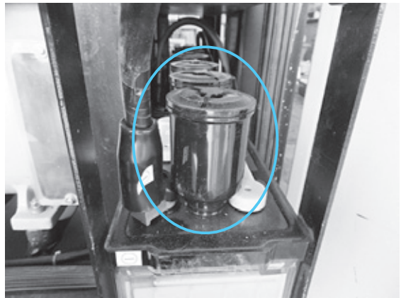
写真20：蓄電池の汚損
