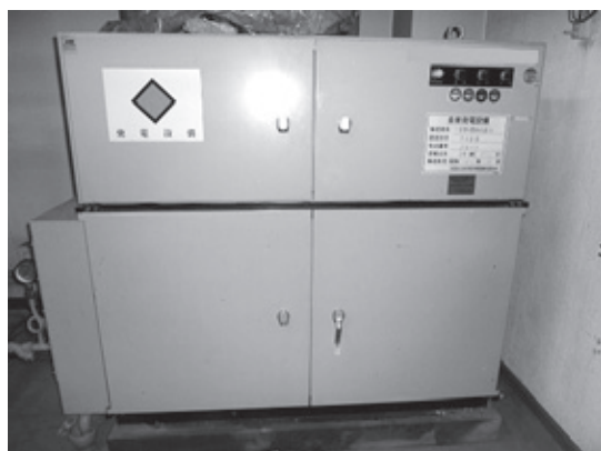
写真1：設備の全体写真
