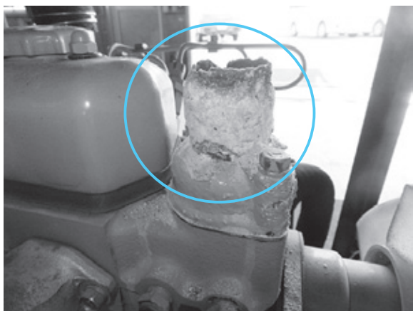
写真6：サーモスタットケースの腐食
