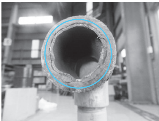
写真26：冷却水パイプの内部の発錆
