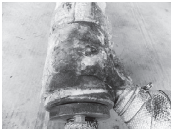
写真24：排気管からの排気ガス漏れ
