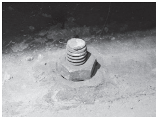
写真4：アンカーボルトの発錆
