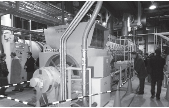
消化ガス仕様のガスエンジン発電設備
