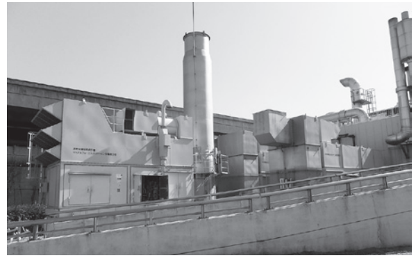
非常用及び常用予備ガスタービン発電設備
