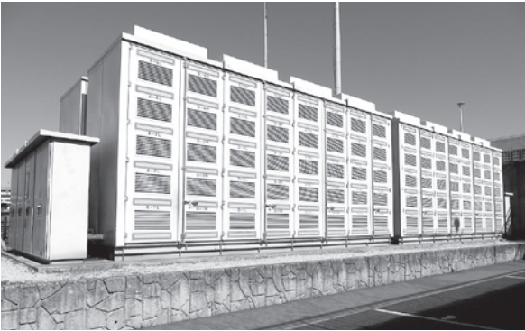
NaS電池2,000kW×4基
