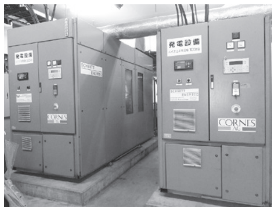
鹿追町 ガスエンジン発電装置
