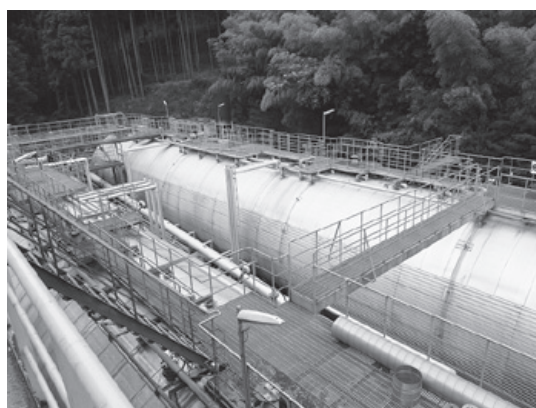
日本で初導入の横型乾式発酵槽
