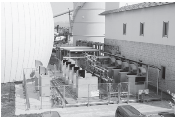
犀川左岸浄化センター ガスエンジン発電設備
