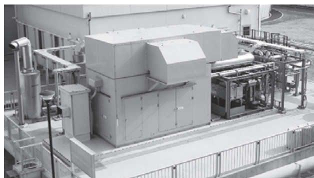
神戸市垂水処理場 660kWコージェネシステム
