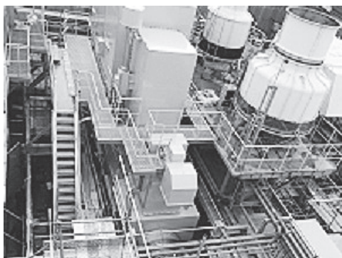
製紙工場のカスタービン発電設備
