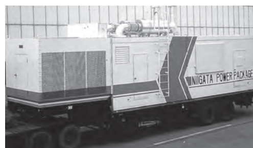
蔭山さんが開発した可搬形発電設備（2,000kVA。昭和59年）
