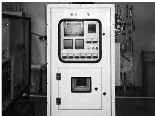
移動発電機車用監視盤
