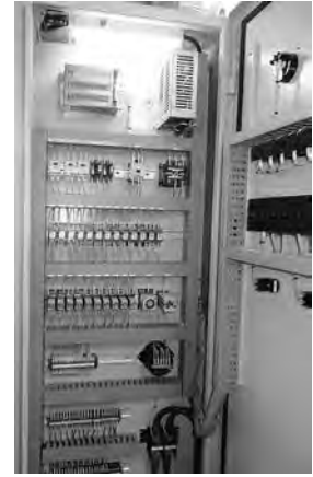
エンジン自動盤の内部
