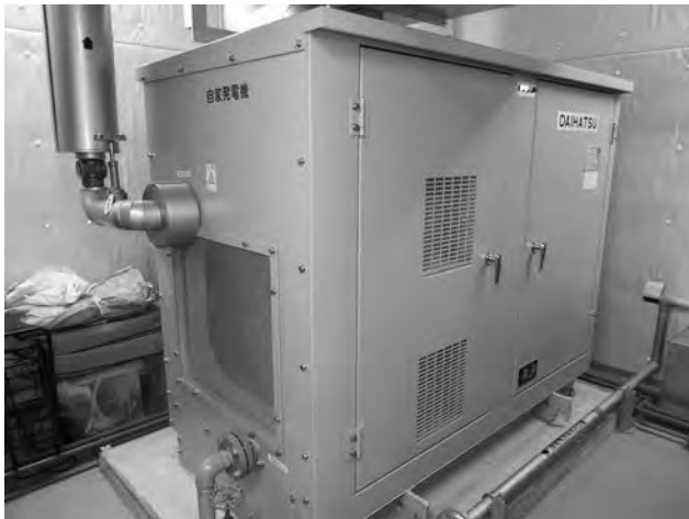
ポンプ施設の自家発電装置
