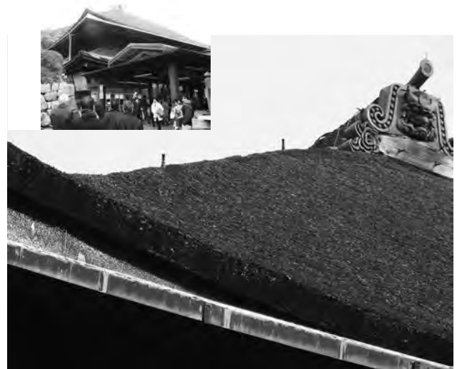
清水寺本堂（上）と本堂屋根ドレンチャー設備
