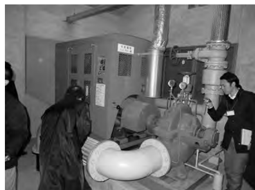
本堂屋根ドレンチャー用非常動力装置
