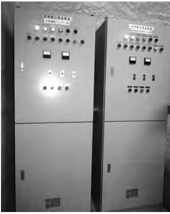
2系統の非常動力用自動盤
