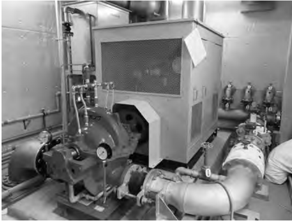
ポンプ施設の非常動力装置
