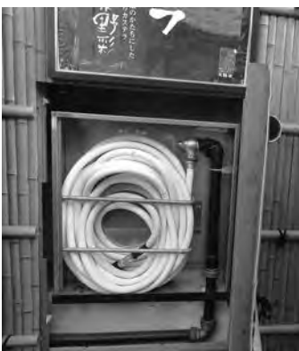
市民用消火栓
