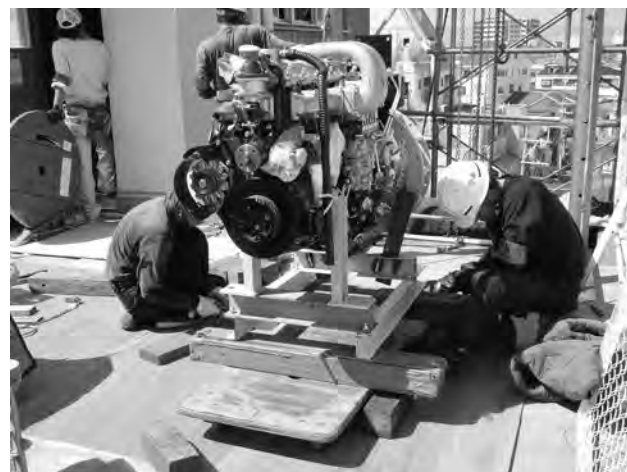
4F屋外部分～屋上まで門型クレーンを使用し揚重、屋上へ揚重後のエンジン
