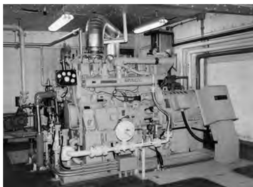
某下水処理場の消化ガス発電設備(240kW、昭和59年)
