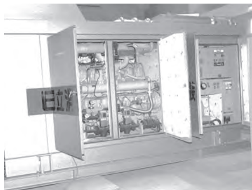
消化ガス発電設備試作機（120kW、昭和58年）
