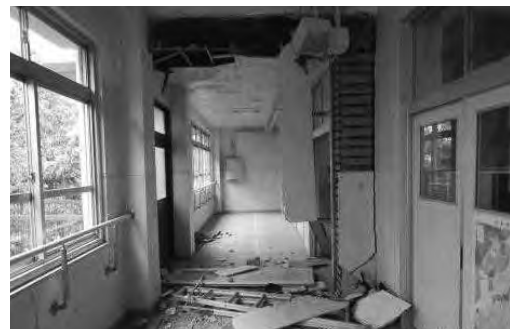
<廊下天井等の破損>
