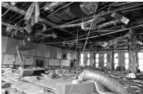
<最上階ホール天井の脱落（校舎）>
