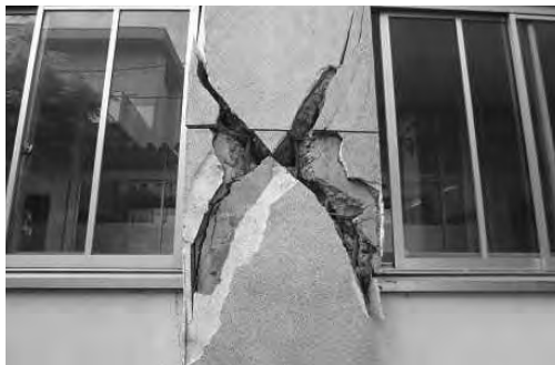
<柱のせん断破壊>
