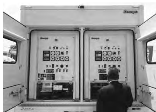
電源車の操作パネル(110kVA×2台)
