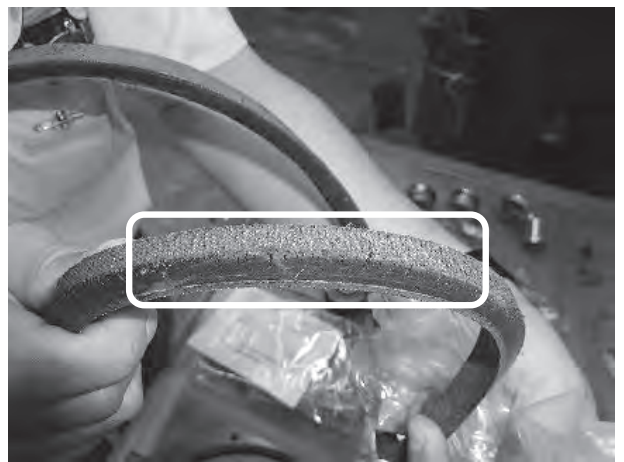
写真5 Vベルトのひび割れ
