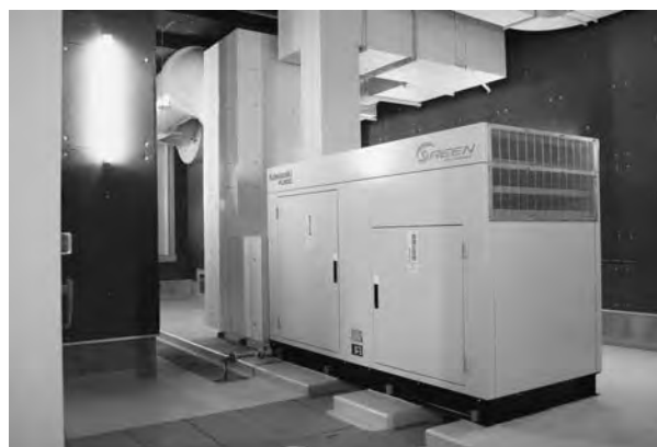
浄水場の自家発（500kVA×1基）
