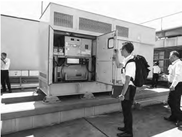
300kVA非常用ディーゼル発電設備
