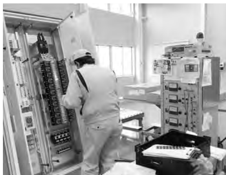
静岡工場 配電盤 検査
