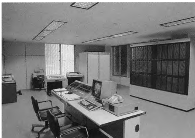
非常用発電設備の遠隔監視システム「GECONYS」 (ヤンマー100年史より)
