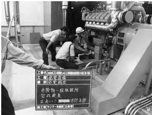
米軍施設での非常用自家発電設備の消防検査
